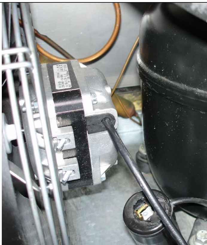
Ventilatore sostituito durante la riparazione.
