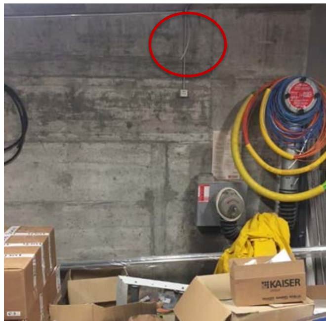
(Photo 2) Extrémité de câble sous tension, non protégée
