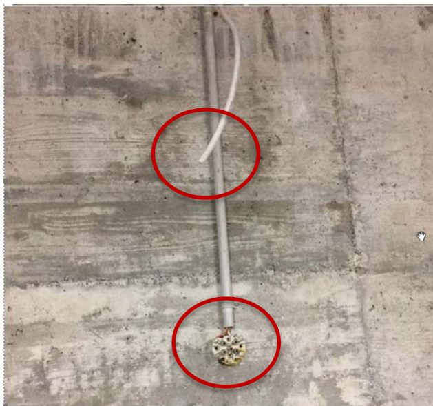
(Photo 1) Situation après l'accident: Extrémité de câble en suspension libre et dispositif de prise ouvert, sous tension
